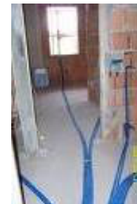
Impianti interni in opera
